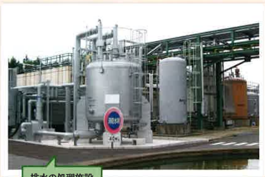
排水の処理施設
